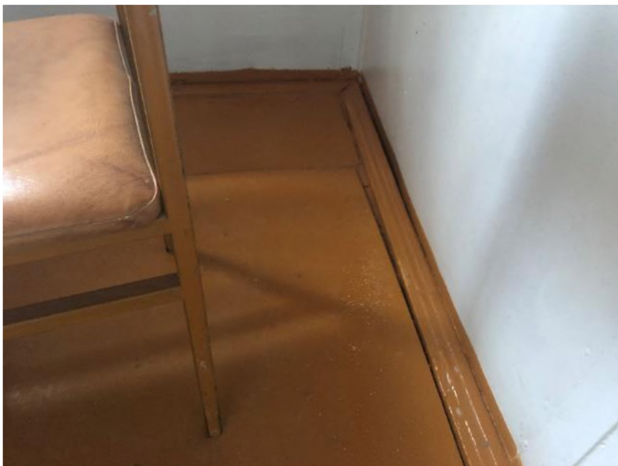
Фото №26. Состояние полов.
