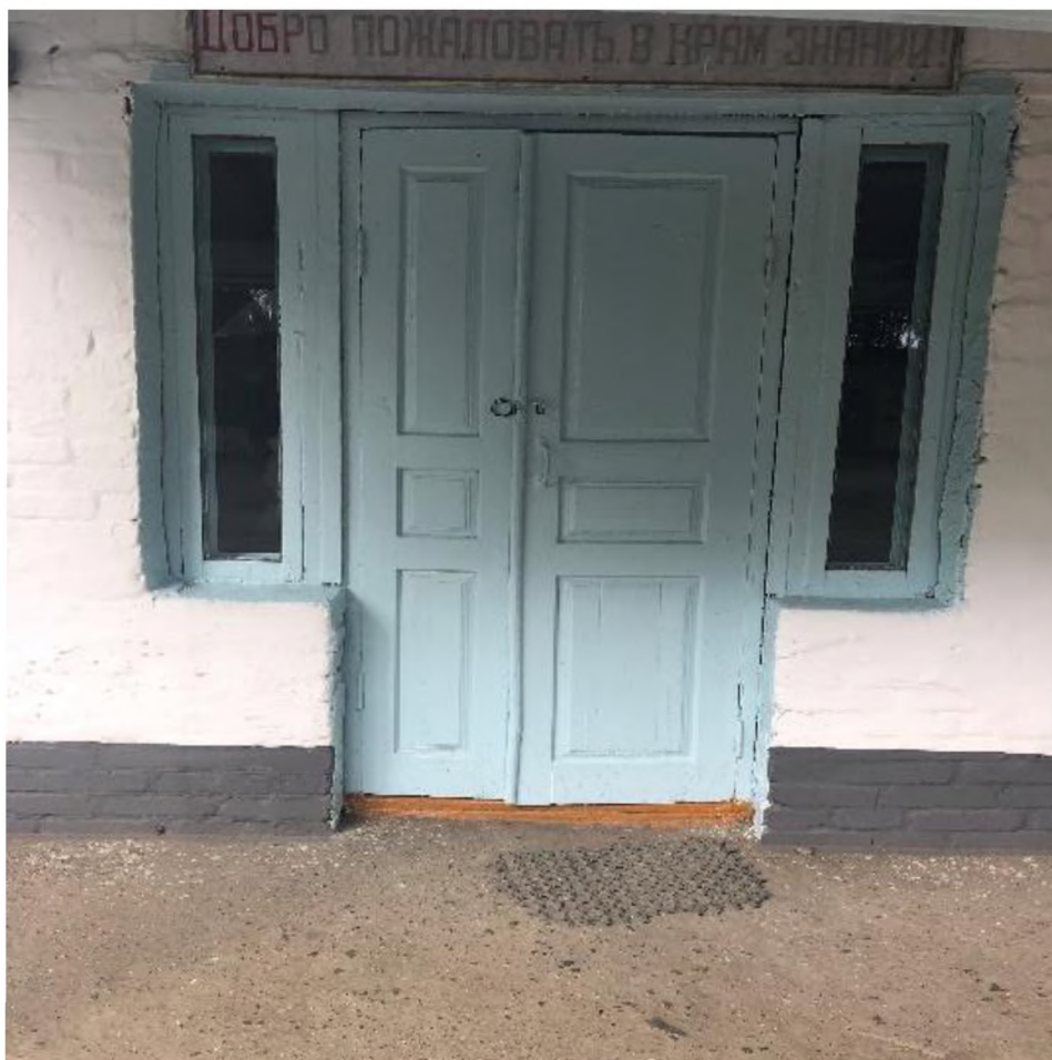
Фото №25. Блок «Б». Состояние дверного блока.
